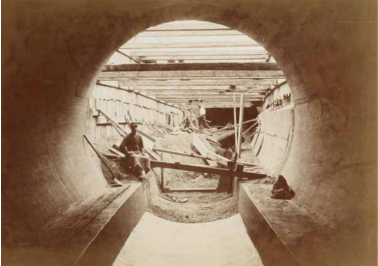
Travaux d'assainissement du Maelbeek. Photo de chantier collée sur carton (© Fonds Victor Besme), tirée du dossier consacré à Victor Besme par Thierry D'Huart dans la revue Bruxelles Patrimoines , n°21, 2016, p.12
